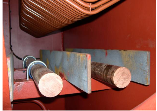
Figura 13. Hastes de cobre (anodos) e placas de aço (catodo) do sistema ICAF montadas separadamente na caixa de mar abaixo do arrefecedor de caixa.
